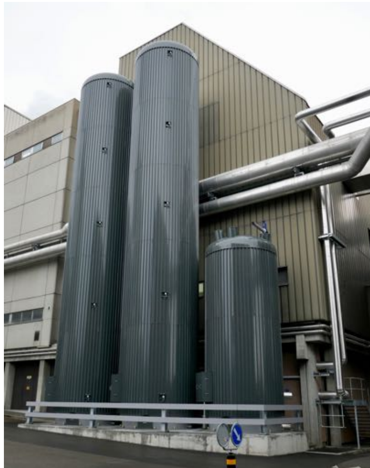
Abbildung: KVA Zuchwil: 2018 ist das erste Jahr Vollbetrieb der neuen Power-to-Heat Anlage für Sekundärregelleistung. Im Bild sind die im Rahmen des Projekts neu gebauten Speicher zu sehen. (Quelle: Ryttec AG)
