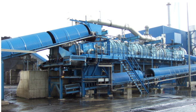
Abbildung 1: Bodenbehandlungsanlage in Eemshaven
